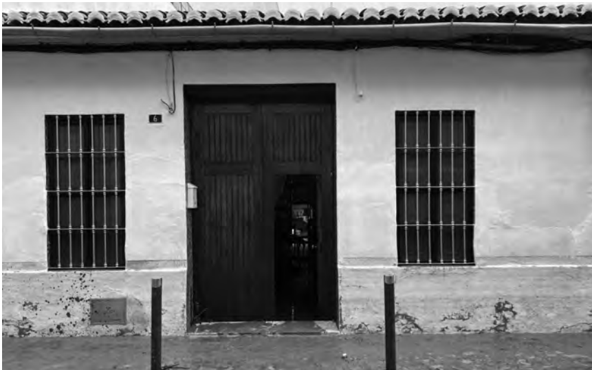
Les marques a la façana indicaven clarament l'altura que havia assolit l'aigua
